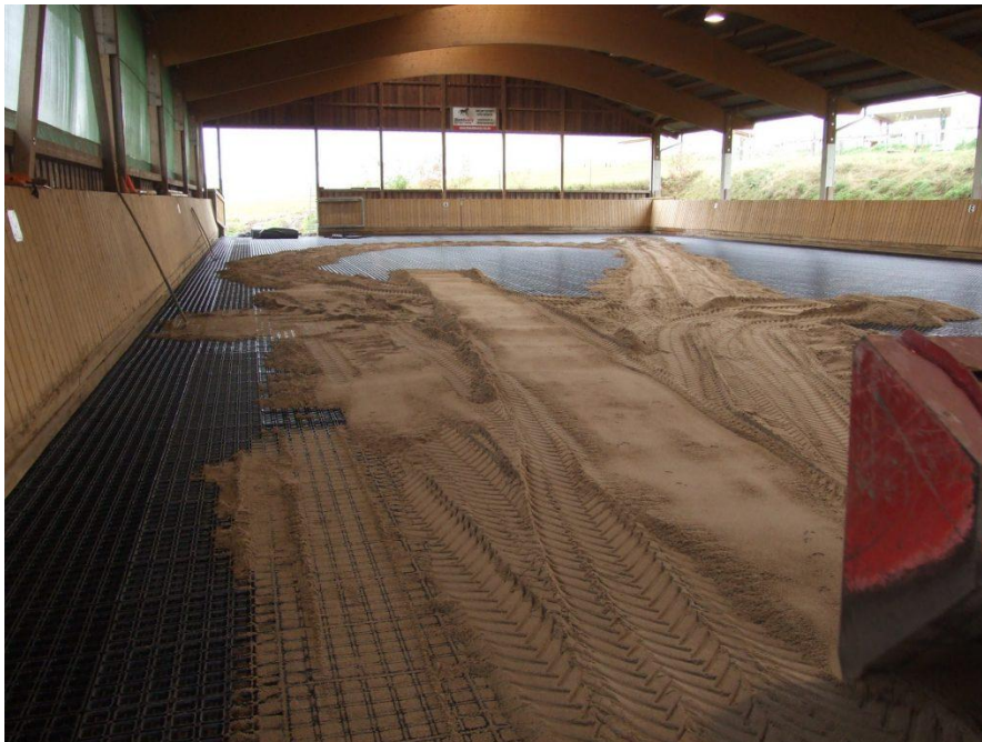
Photo n°7 : Subirrigation d'un manège
